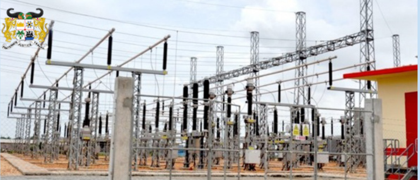
LA CENTRALE ENERGETIQUE DE MARIA-GLETTA
